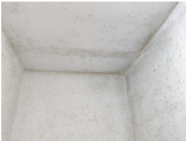
FOTO APPARTAMENTO PROP [REDACTED] (2° PIANO) [UMIDITA' DA CONDENSA]
